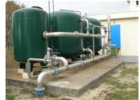
Filtration sur sable
